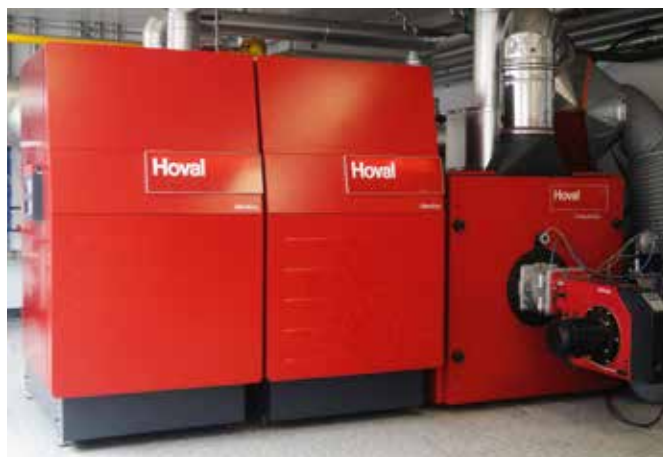
Monovalente Kaskade aus 2 UltraGas® und einem CompactGas als Spitzenlastkessel.
