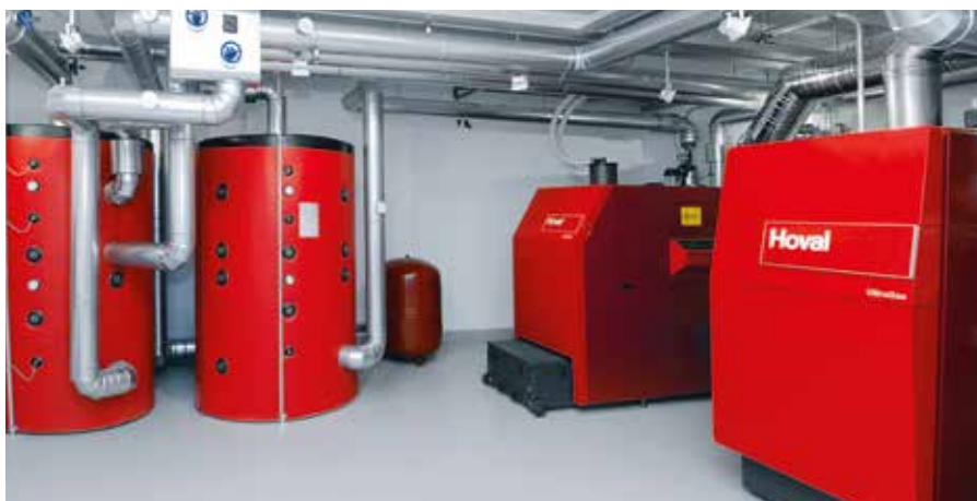
Bivalente Kaskade mit Pelletkessel BioLyt (160) für die Grundlast und der Gas-Brennwertkessel UltraGas® (250) zur Abdeckung der Spitzenlasten.
