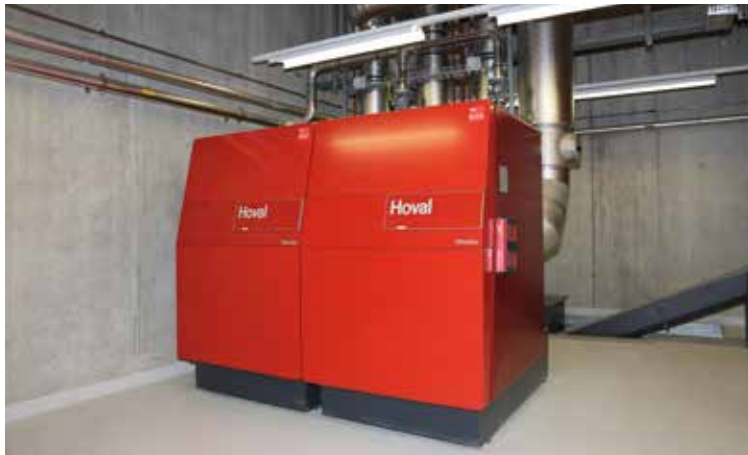
Heizzentrale für einen Nahwärmeverbund: 1 Doppelkessel UltraGas® (1300D) sorgt für höchste Effizienz- und das bei hoher Ausfallsicherheit.
