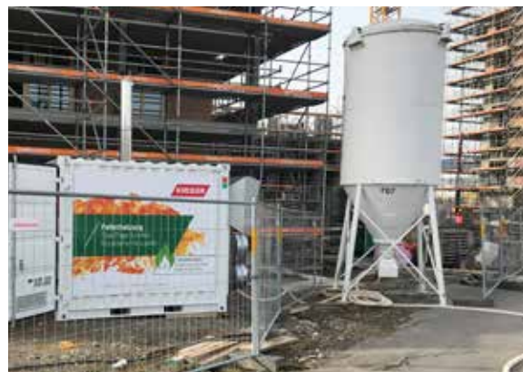
Chauffage à pellets de 220 kW
