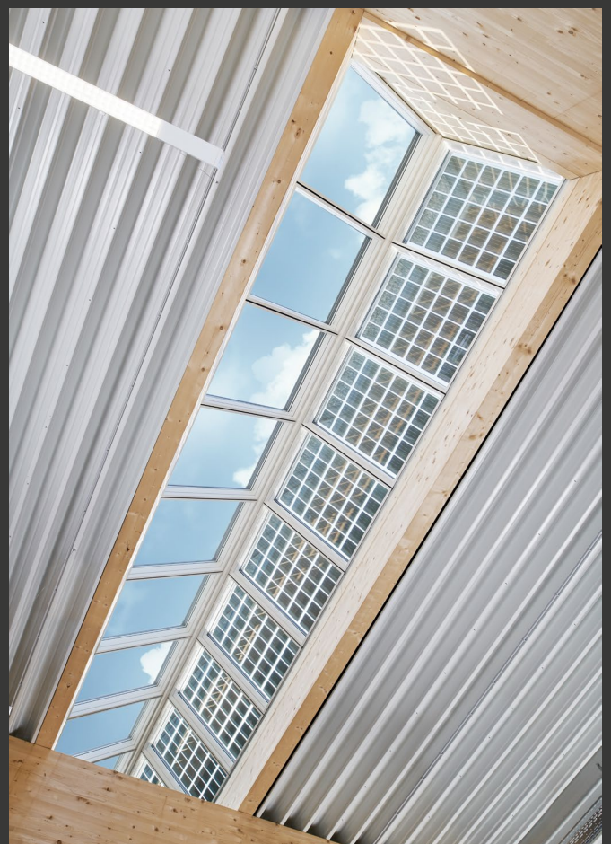
Raiffeisen-Lagerhaus, Kufstein, Österreich. 2 Sattel-Lichtbänder, 92 Module inklusive Photovoltaik-Elementen.
