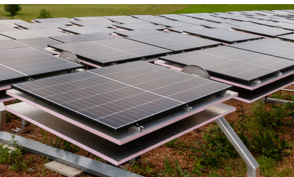
Photovoltaik-Modul zur Energiegewinnung.
