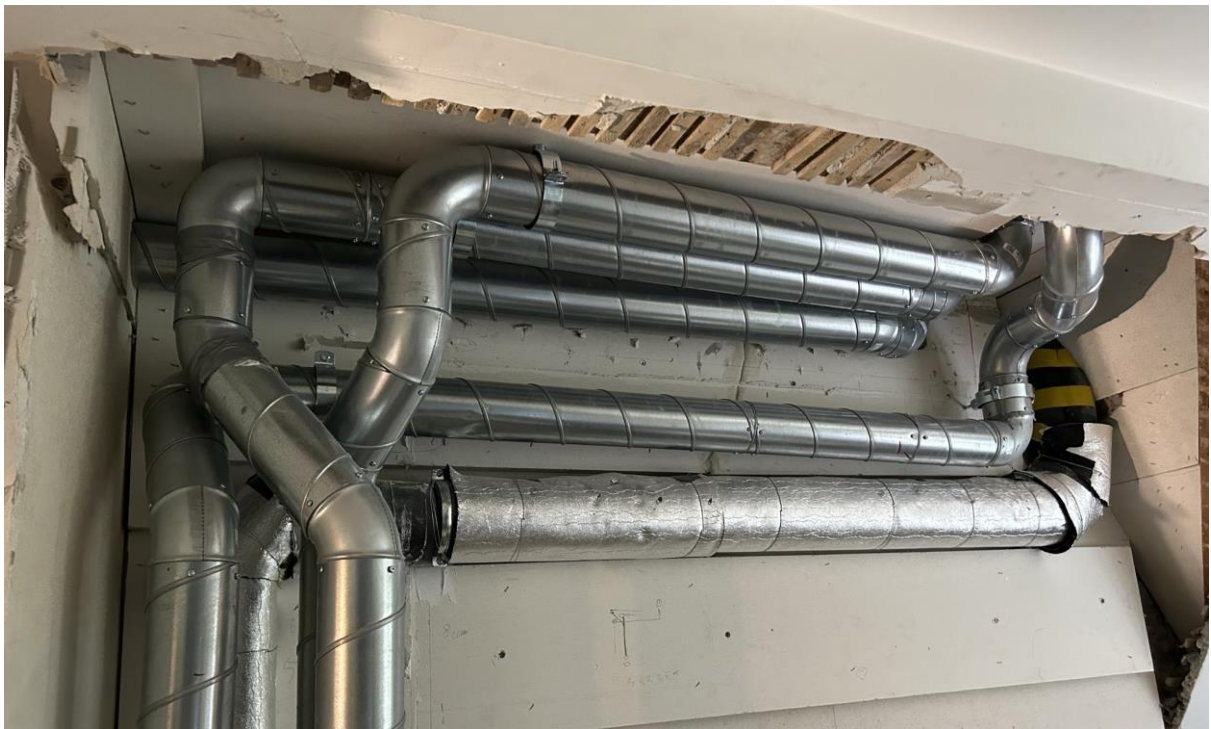
Komplexe Leitungsführung für die Kontrollierte Lüftung der Villa Lindeneck im Juli 23
