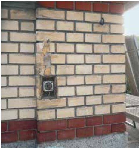
Ecklisene mit altem Elektrostecker, der nicht mehr benötigt wird
