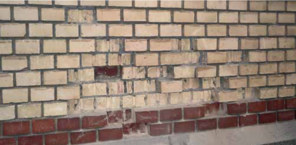
Fläche im Erdgeschoss mit vielen defekten Steinen
